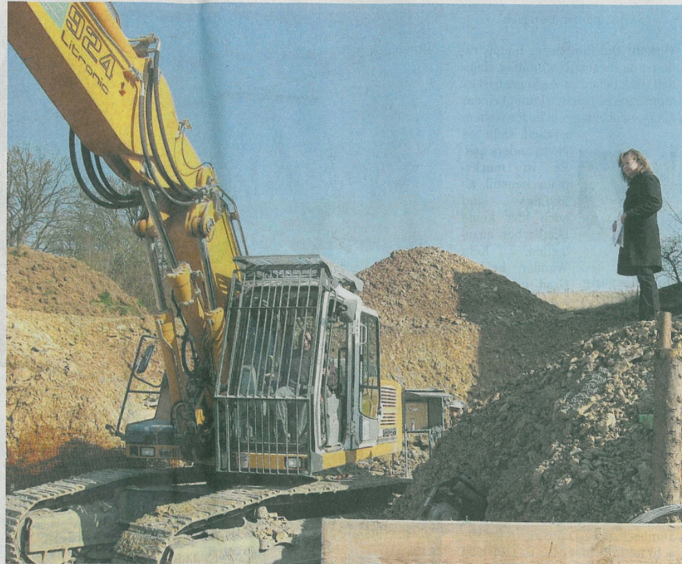
Simone Seyfang (rechts hinten) behält auch dann den Überblick, wenn die männliche Belegschaft anfängt zu baggern. Seit zehn Jahren arbeitet die heute 33-Jährige jetzt schon als Bauleiterin.
